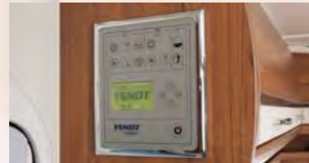
Centraal schakelpaneel met kinderschakelaar bij de ingang voor licht, indicatie waterniveau, tijd, temperatuur en regeling vloerverwarming
